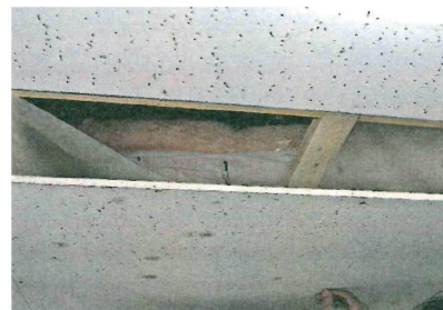
断熱材の結露
